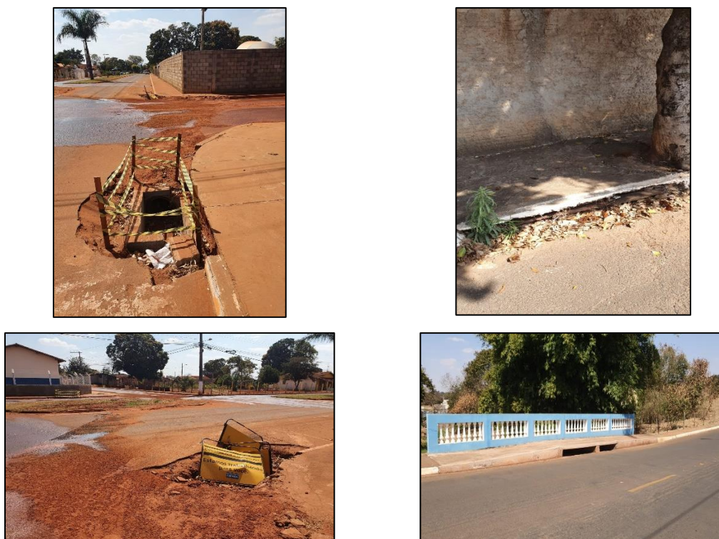
Figura 73 - Dispositivo de drenagem.
