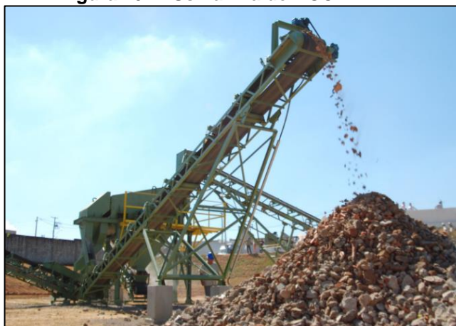
Figura 104 - Usina fixa de RCC.
