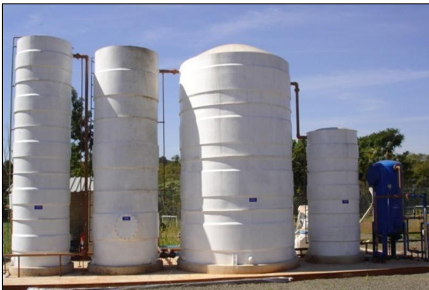
Figura 28 – Estação Compacta de Tratamento de Esgotos Sanitários.
